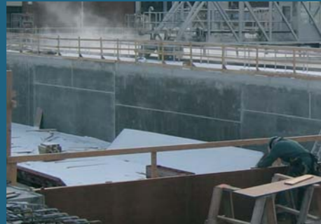
Čistírna odpadních vod, Kanada
